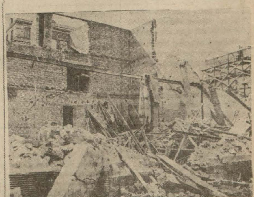
Dün sabah Tahtakalede yeni yapılan dört katlı bir bina çökmüştü. Tasfiatını şehir haberlerimiz arasında verdiğimiz bu hâdiseye ait resmi yukarıya koyuyoruz.
